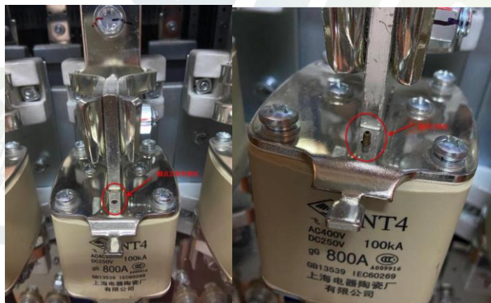
图5-7-1熔断器故障判断 (左: 正常, 右: 故障)
