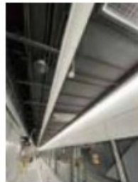
站厅站台采用 室内型物联网基站
