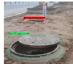
智能识别管井风险 (缺失、翘起、破损)
